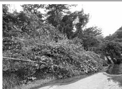
宮交の高速バス停の駐車場への道、左側は高速道路。道路脇が崩れ、フェンスが土砂に押しされ木が道路をふさいでいる。
